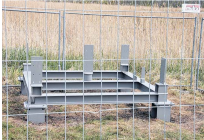
Das Fundament für den neuen Ausguck ist bereits montiert. Ende Mai soll er eingeweiht werden.
